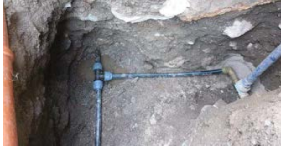
Wasserleitung Moser (Brugger) und Garage Ortner (war alt und undicht)
